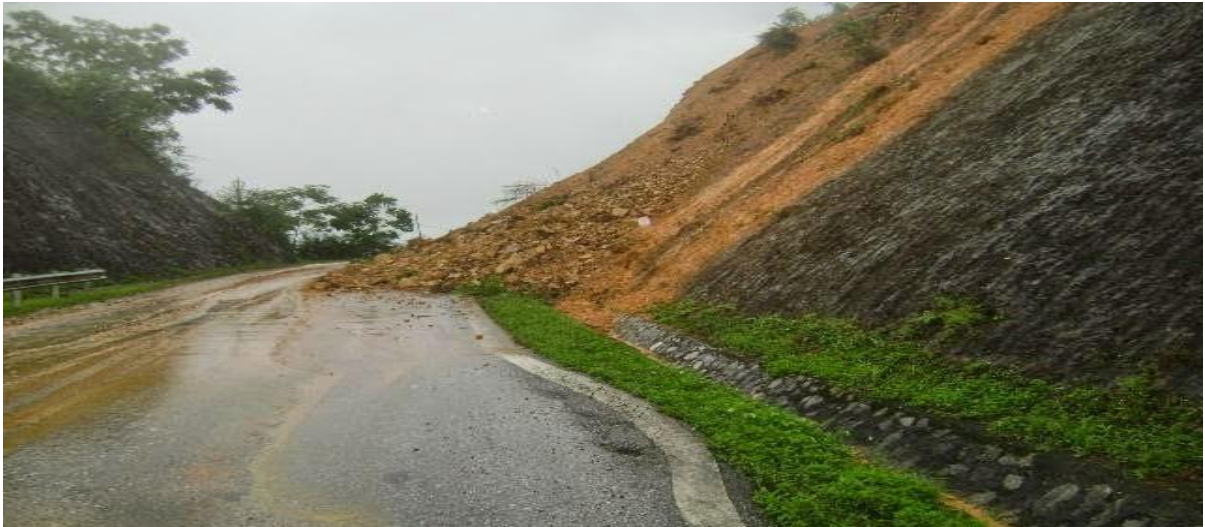
Hình 24. Hình ảnh đất sụt
