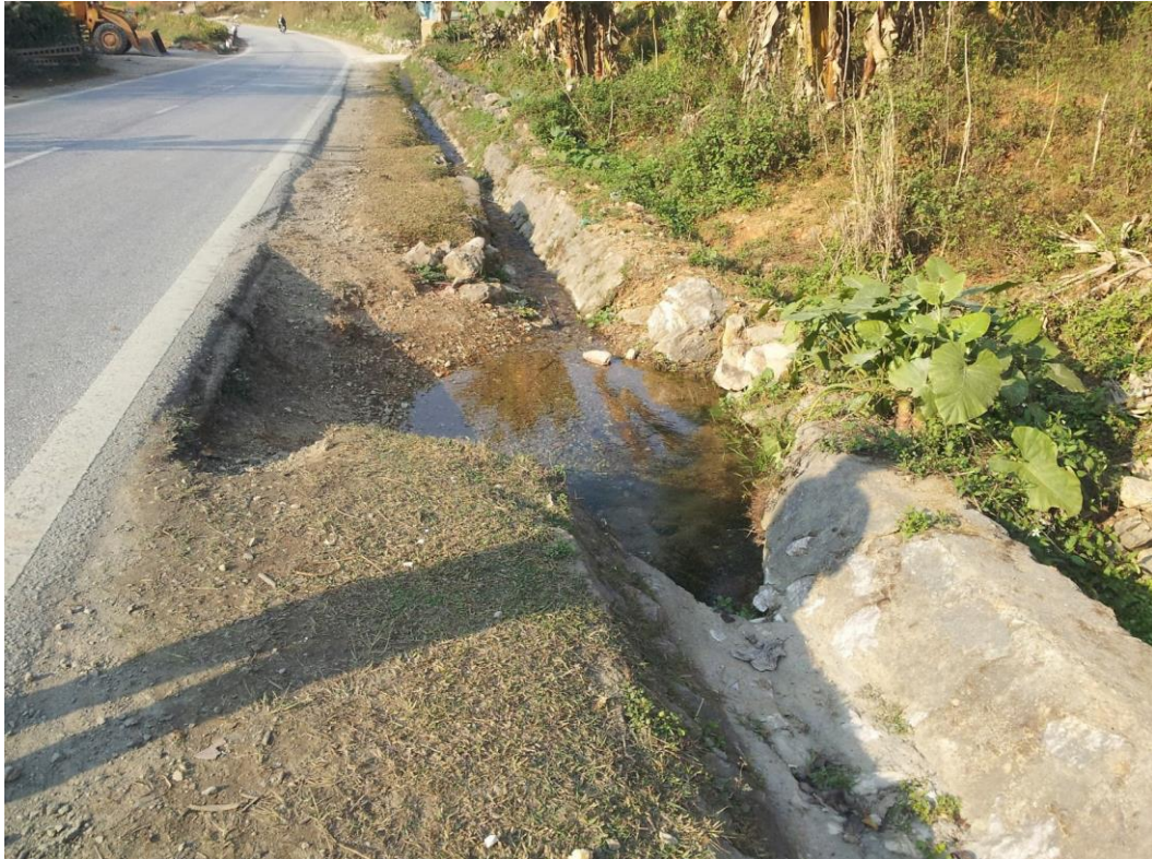
Hình 9. Rãnh xây dọc đường giao thông bị xói mòn
