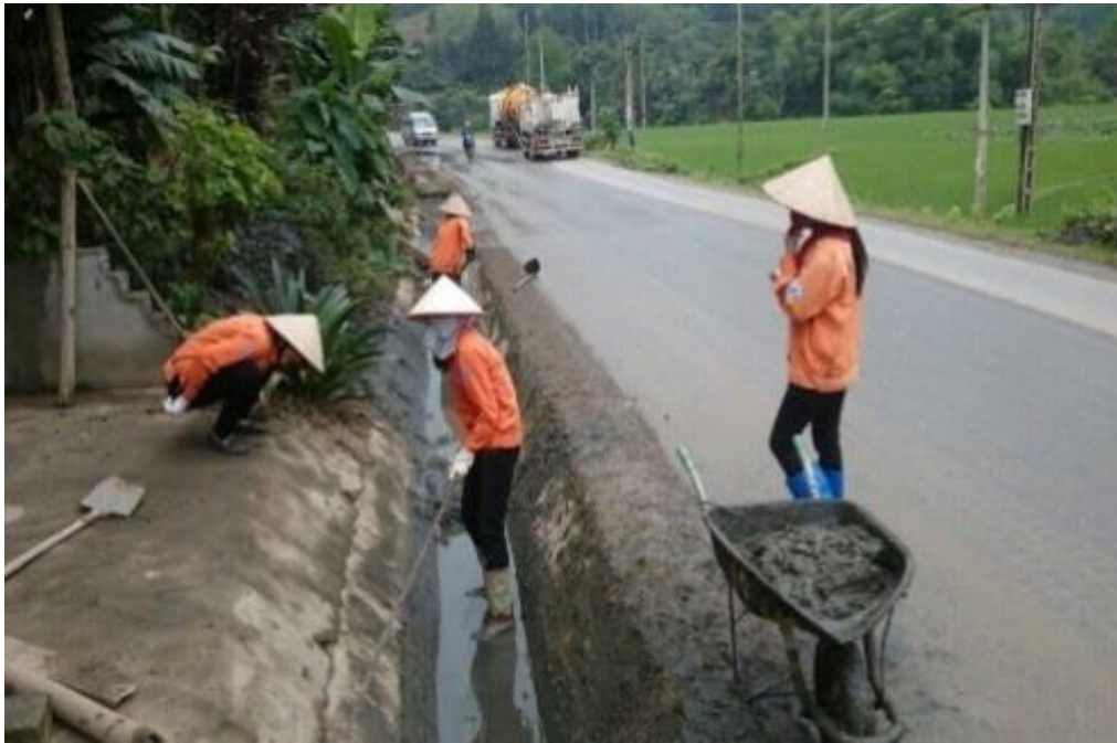
Hình 11 – Công nhân đang đào bỏ bùn đất trong lòng rãnh xây có lát đáy
