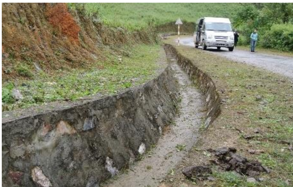
Hình 13 – Rãnh đá xây ven đường đã được vệ sinh sạch sẽ
