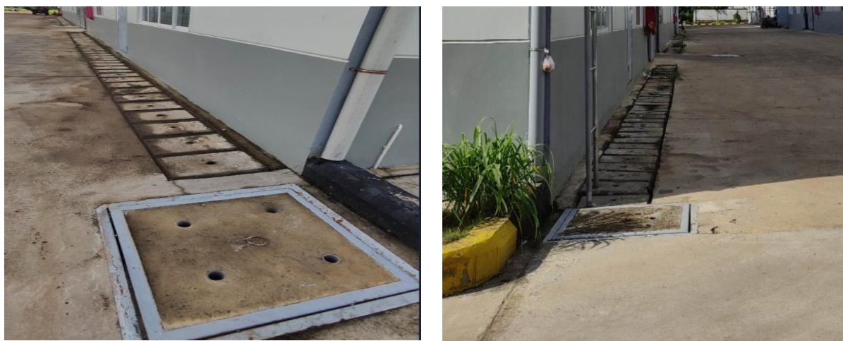
Hình 4.1. Hệ thống mương, hố ga thu gom nước mưa hiện hữu
