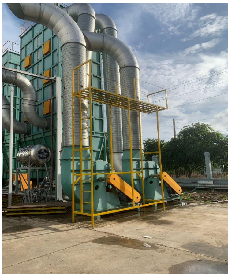
Hình 4.6. Hệ thống xử lý bụi gỗ công suất 54.000 m 3 /giờ
