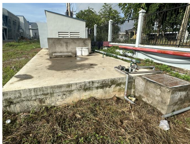
Trạm xử lý nước thải hiện hữu
