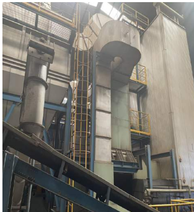
Cyclone lọc bụi và Ventury của Lò nhiệt công suất 6.000.000 kcal/giờ
