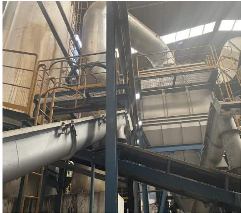
Cyclone lọc bụi và Ventury của Lò hơi, công suất 19 tấn hơi/giờ
