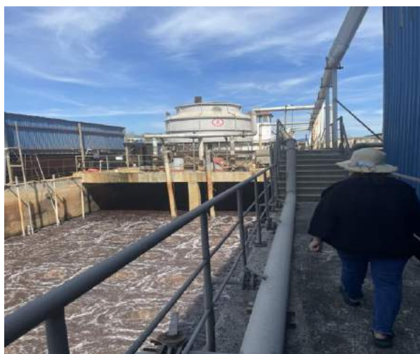
Bể điều hòa và tháp giải nhiệt
