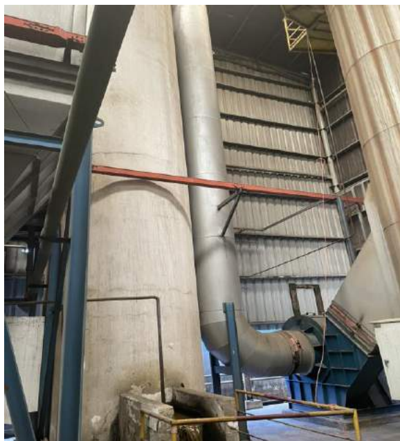
Tháp lọc bụi ướt của lò nhiệt công suất 6.000.000 kcal/giờ
