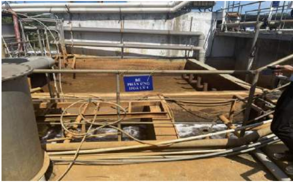
Bể trộn, khử màu, bể tạo bông đợt 1
