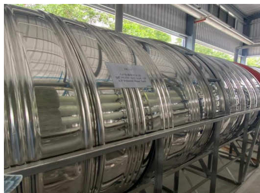
Bể chứa nước sau lọc UF
