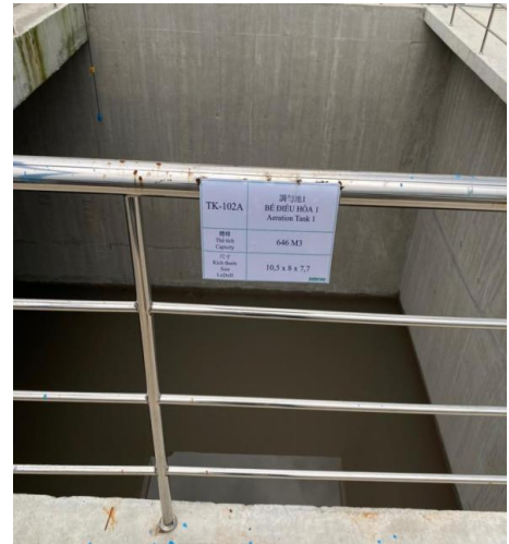
Bể điều hòa 1
