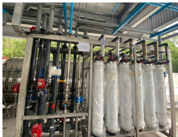
Hệ thống lọc UF
