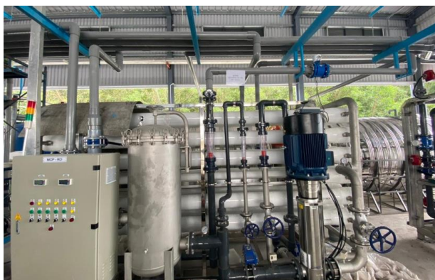
Hệ thống lọc RO
