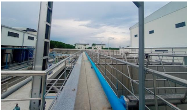
Hệ thống xử lý nước thải
