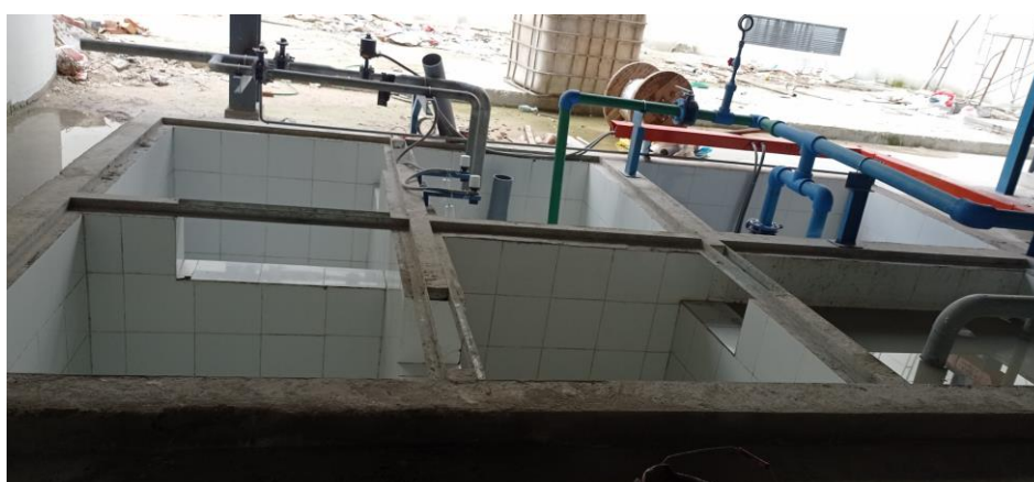
Hình 4.4. Hố lắng bùn hệ thống xử lý khí thải lò hơi
