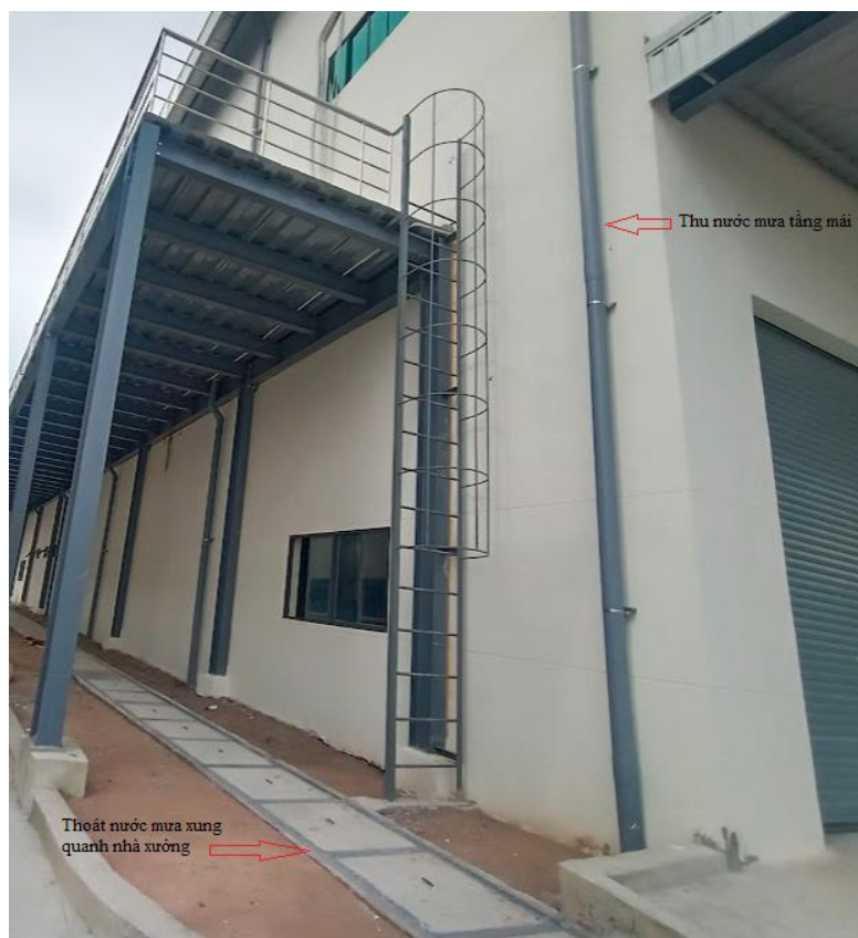
Hình 4.17. Hệ thống thu gom, thoát nước mưa
