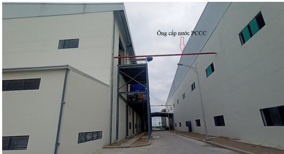
Ống cấp nước PCCC giữa các nhà xưởng
