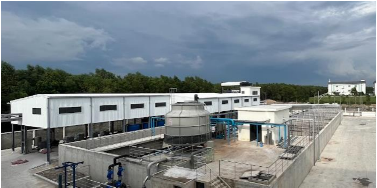
Toàn cảnh khu xử lý nước thải của nhà máy
