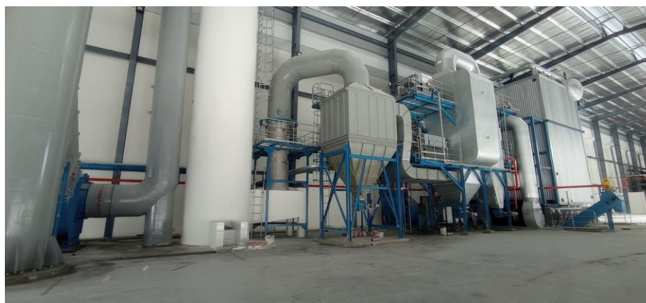
Hình 4.3. Hệ thống xử lý khí thải lò hơi
