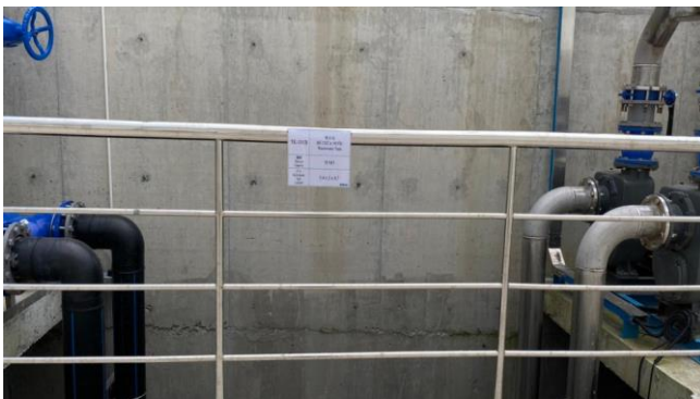
Bể chứa nước
