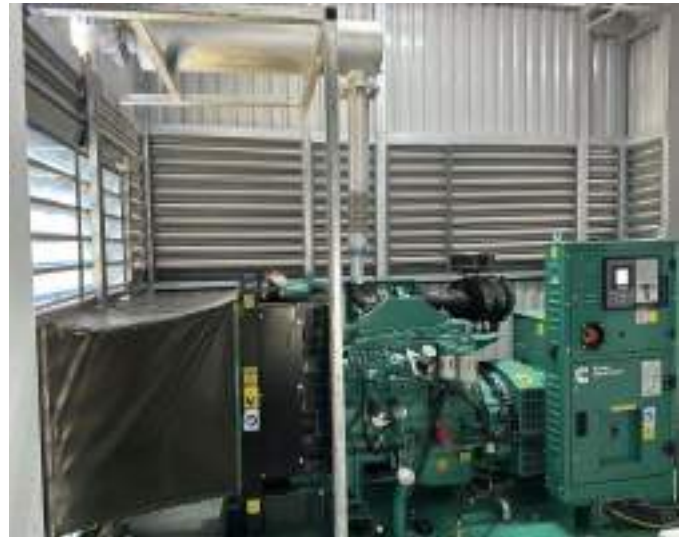
Máy phát điện
