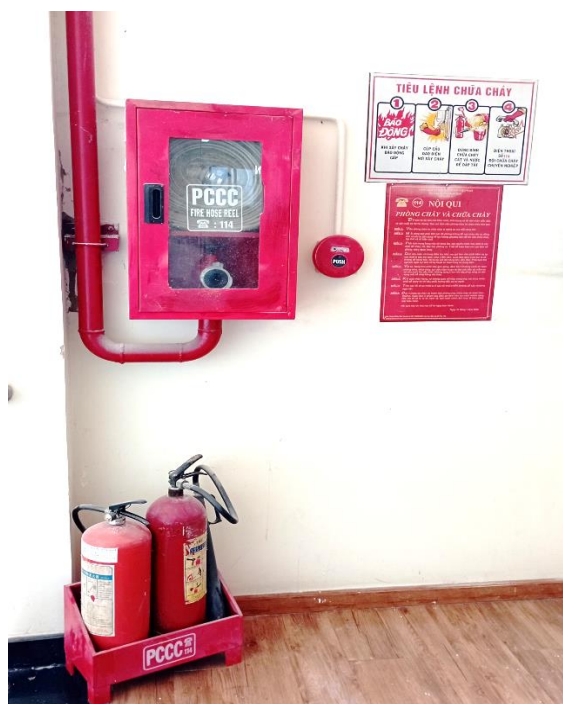
Hình 3.16 Thiết bị PCCC của dự án
