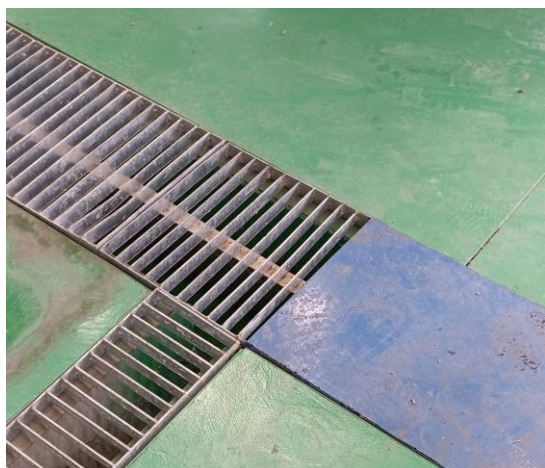
a) Tuyến mương hồ thu gom nước thải bên trong nhà xưởng
