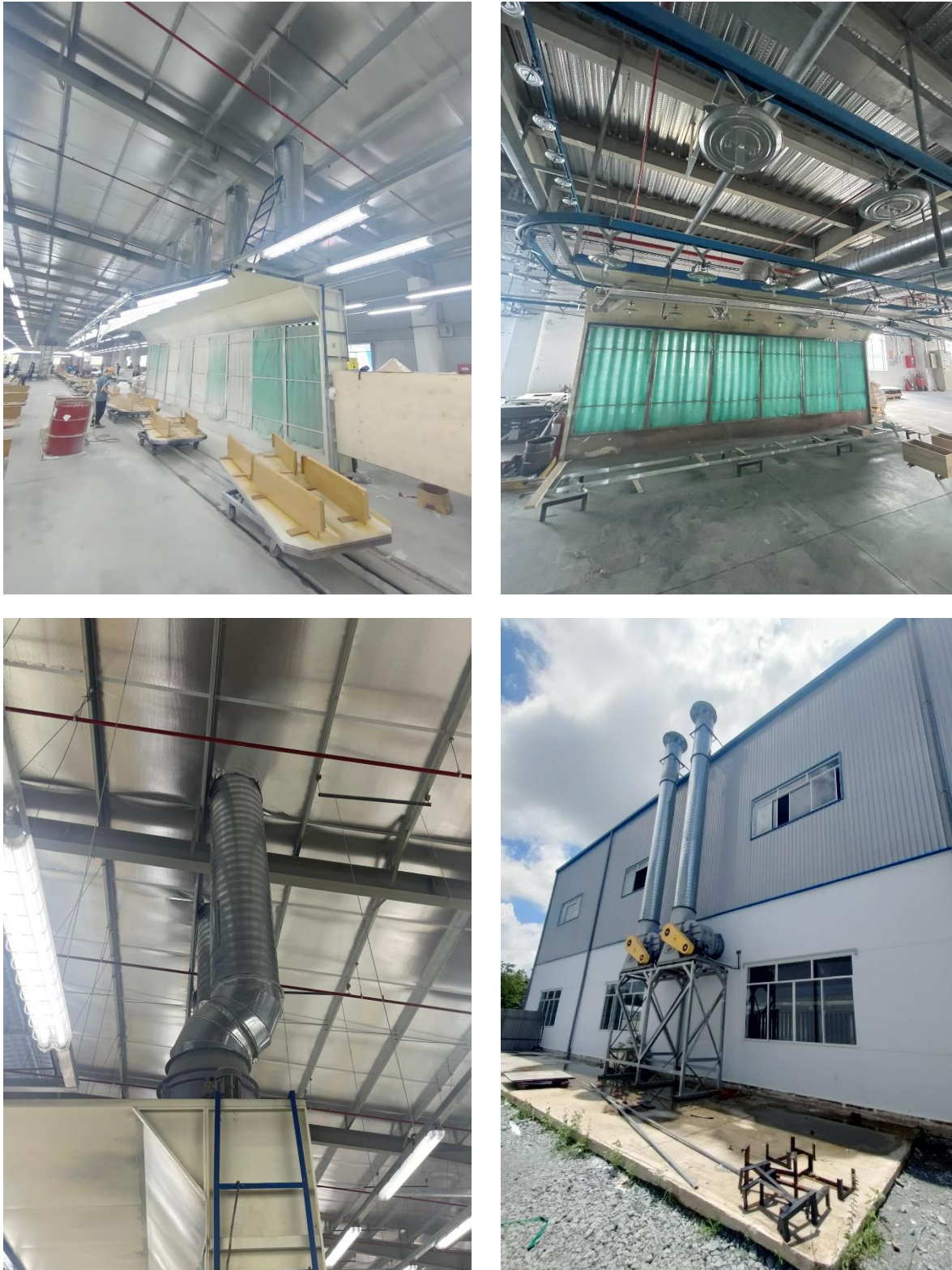
Hình 3.14 - Hệ thống thu gom và xử lý khí thải từ quá trình sơn
