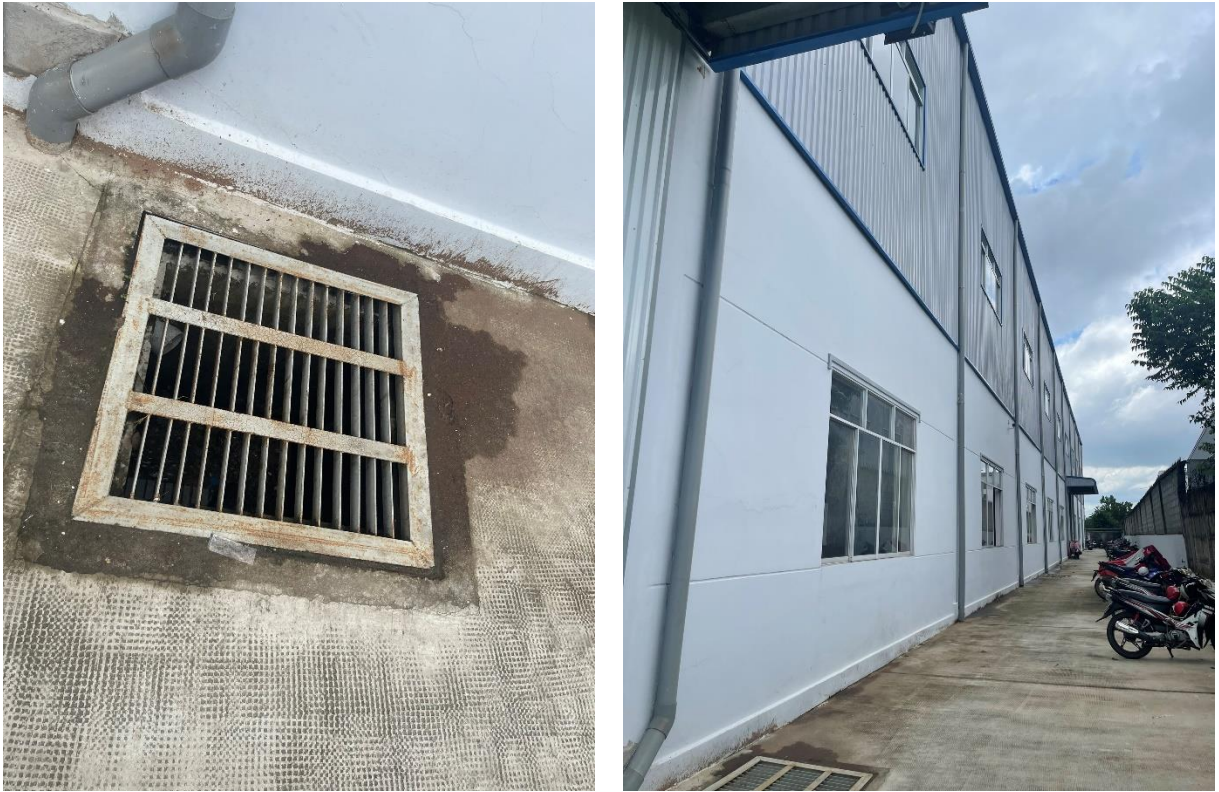
Hình 4.15 Hệ thống thu gom nước mưa hiện hữu
