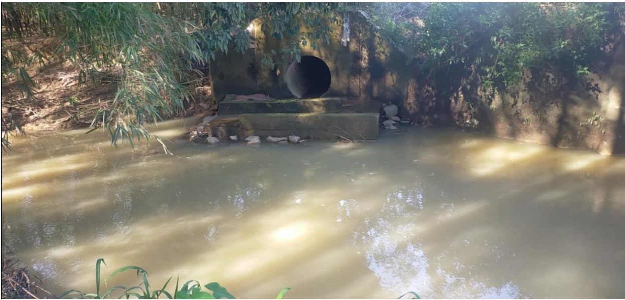
Hình 3. 3. Hình ảnh cống xả nước thải của KCN ra suối Dinh
