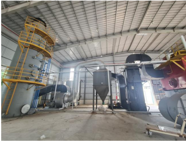
Hệ thống xử lý khí thải lò hơi
